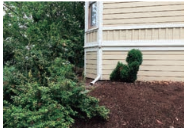
写真-1 ポートランドの住宅における縦樋の非接続と雨庭への導水
